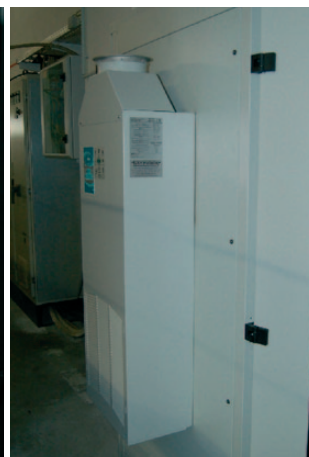
Montiertes Gerät mit Ablufttrichter, ohne Abluftschlauch
