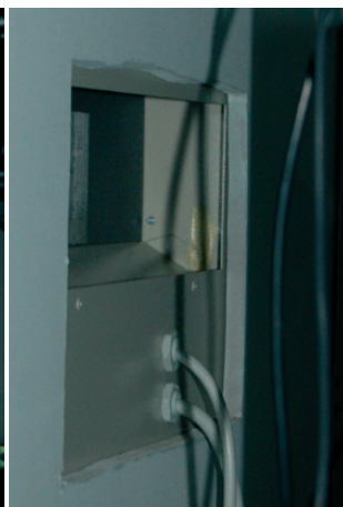
Durchbruch Luft Austritt
